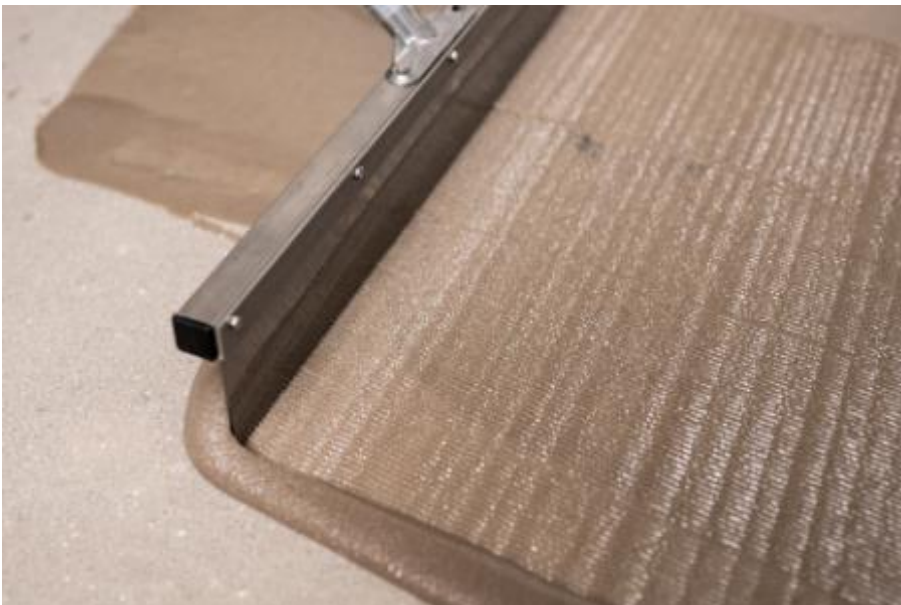
Die vorgefüllte Kratzspachtelung (PCI Apoten OS P mit Quarzsand 0,1 - 0,4) wurde auf die am Vortag aufgebrachte Grundierung mit einer Zahnrakel appliziert. (Link zum hochauflösenden Photo )
